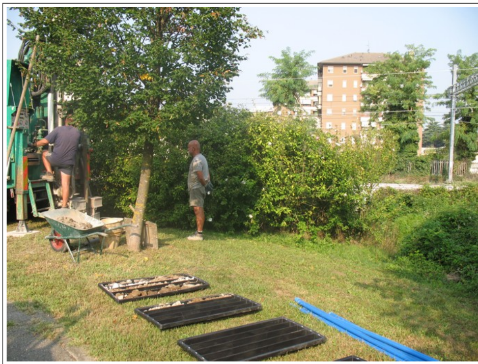
Sondaggio S1: fase d'avanzamento della perforazione con alloggiamento delle terre campionate nelle cassette catalogatrici
