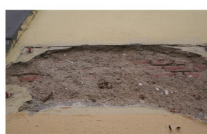
Particolare dell'intonaco realizzato con più strati sovrapposti su muratura in mattoni. Tutto l'intonaco risulta realizzato in più strati dovuti anche a rappezzi, rifacimenti successivi prevalentemente con malta cementizia.
