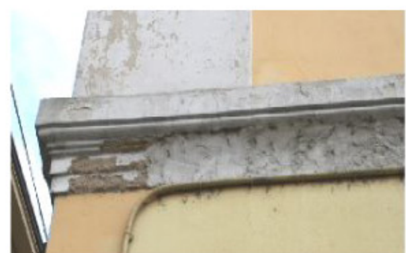
Particolare delle lesene orizzontali realizzate con mattoni e modellate in opera con malta di cemento (non originale), ricoperta da innumerevoli strati di pitturazioni successive.
