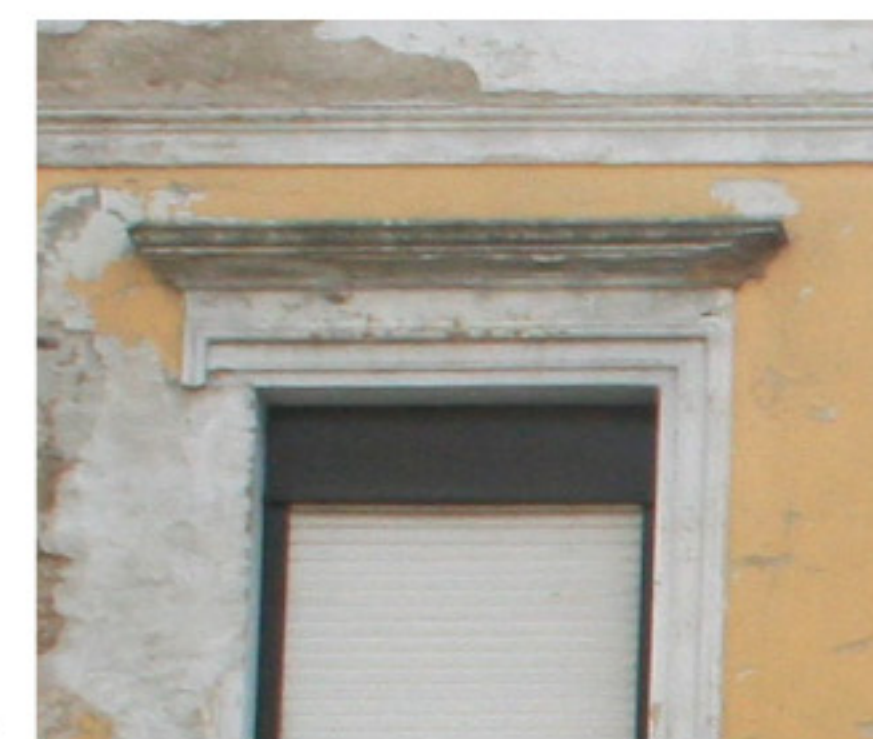
Particolare delle decorazioni sopra finestra, realizzate in cemento lavorato a piè d'opera. Anche in questo caso, il degrado degli elementi, il distacco di porzioni e gli strati di stuccature / tinteggiature successive, rendono difficile la lettura della lavorazione delle superfici.
