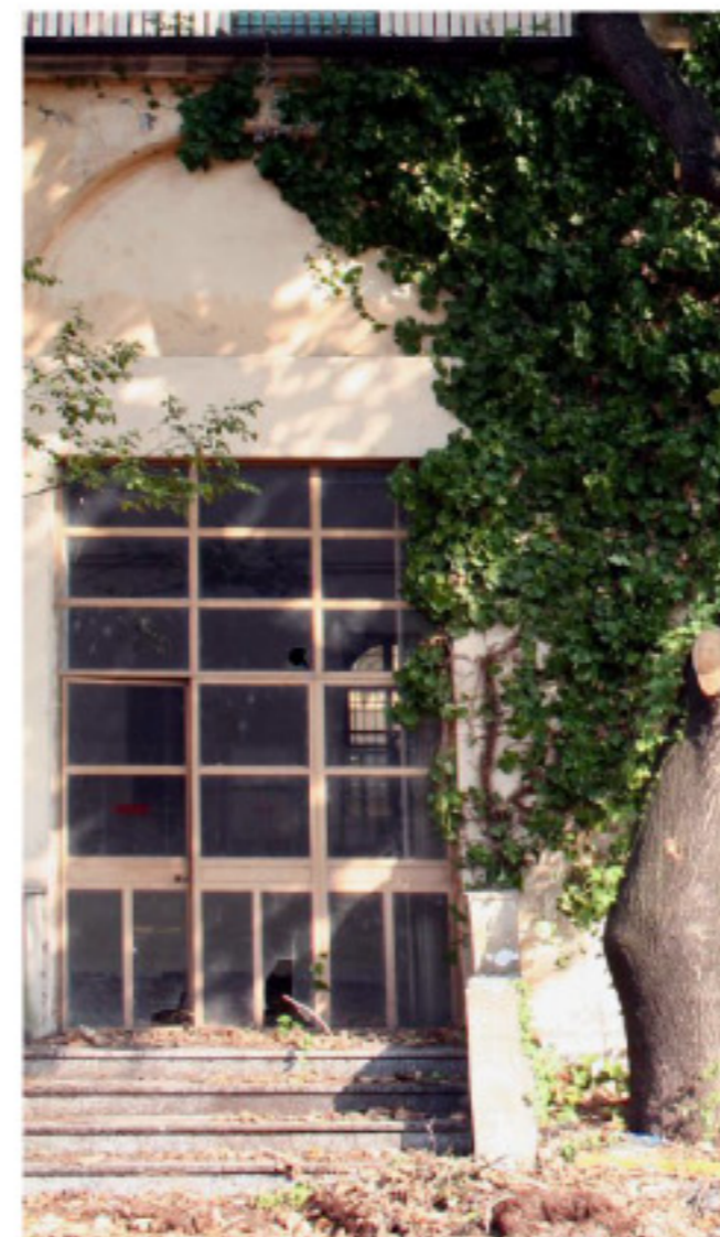
Particolare dell'infisso realizzato in ferro e della gradinata d'accesso con pedate e alzate rivestite in pietra.
