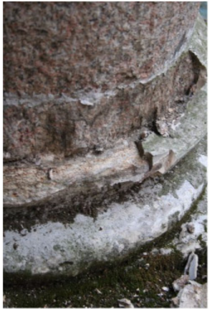
Particolare del basamento della colonna caratterizzato da distacco del materiale lapideo dovuto alla migrazione dei sali favoriti dall'umidità di risalita.
