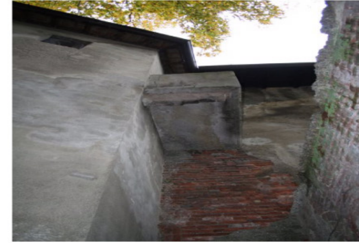
La facciata risulta realizzata da intonaco cementizio, rappezzato più volte e con caratteristiche chimico fisiche non omogenee. Nelle porzioni cadute si evidenzia la struttura muraria originale realizzata con mattoni pieni. Nella foto si evidenzia il banchoccolino con elementi in pietra.
