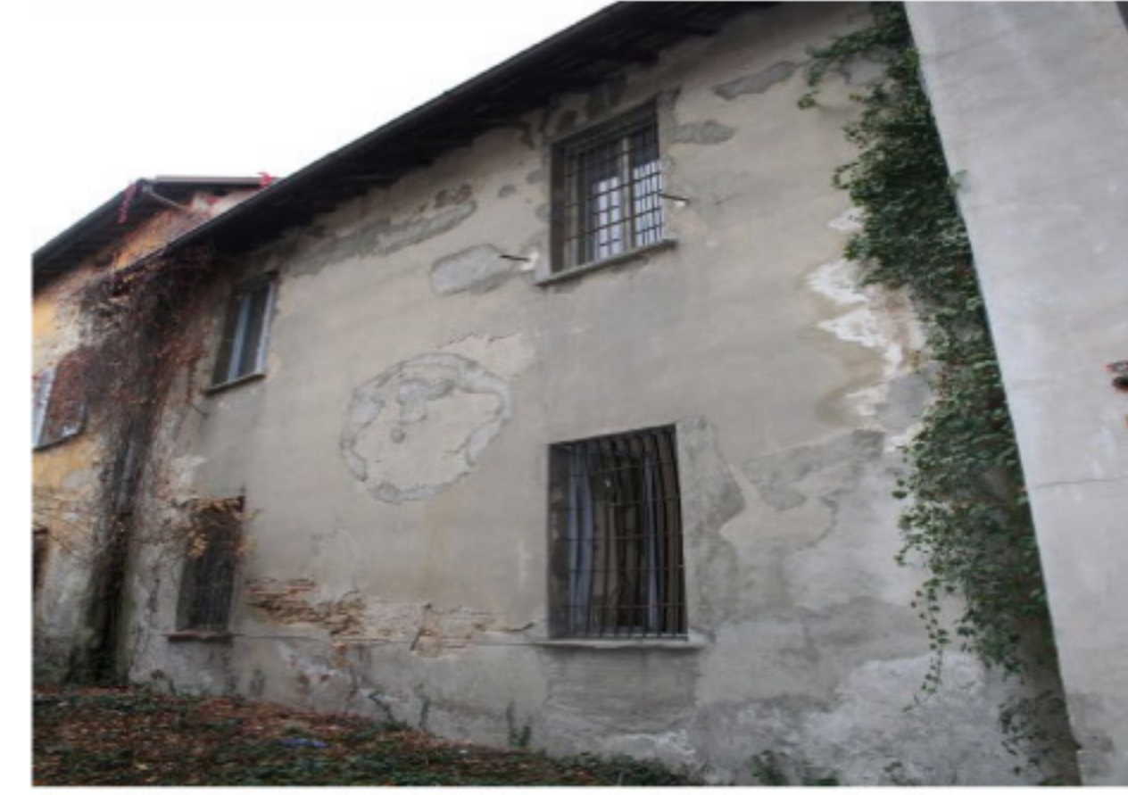
Particolare della parete caratterizzata dalla presenza di fenomeni di efflorescenza, caratterizzati dalla formazione di sostanze, dal colore biancastro e di aspetto cristallino e da fenomeni di sub-efflorescenza con cristallizzazione all'interno del materiale provocando il distacco dell'intonaco, permettendo all'acqua di percolare all'interno, raggiungendo e causando un inizio di degrado anche allo strato di mattoni. Inoltre, è possibile notare, nella parte inferiore della parete l'umidità di risalita capillare, tale fenomeno accentua le alterazioni delle efflorescenze.
