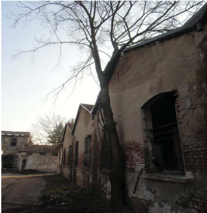
Foto n°3: l'olmo è radicato alla base del muro del capannone.
