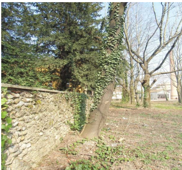
Foto n°10: l'ailanto cresce a ridosso del muro di confine ed è inclinato.
