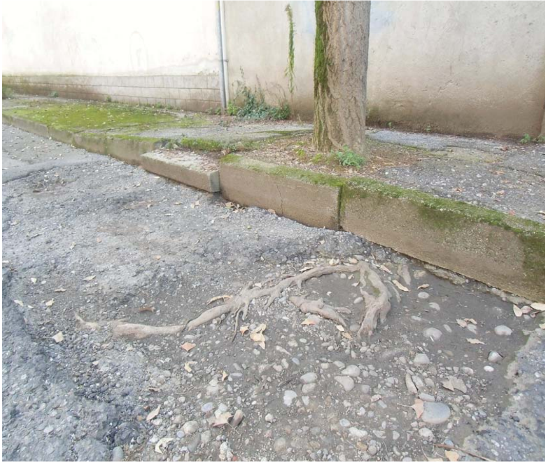
Foto n°17: la pianta di ginkgo ha sollevato le radici, portando al movimento del cordolo e dell'asfalto.
