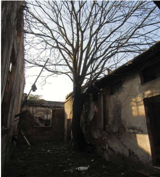
Foto n°1: l'ailanto è cresciuto alla base dell'edificio.
