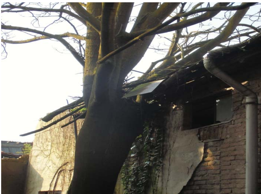
Foto n°2: la pianta è appoggiata alla gronda ed al tetto dell'edificio.
