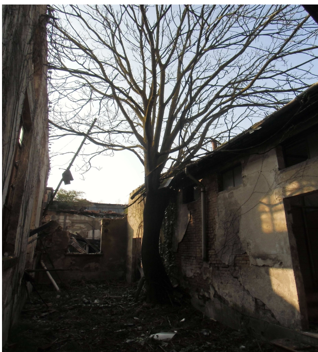
Foto n°1: l'ailanto è cresciuto alla base dell'edificio.
