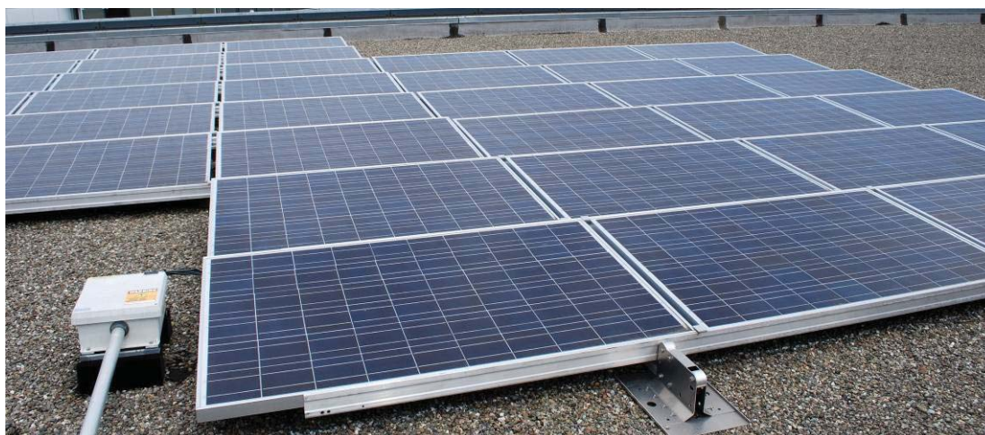
Fig. 32: impianto fotovoltaico su copertura piana
