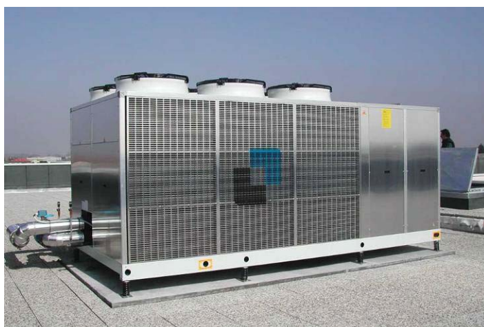
Fig. 16: Macchina pompa di calore ad aria
