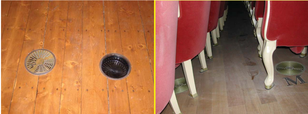
Fig. 28: Sistema di ventilazione a dislocamento Teatro La Fenice – Venezia.
