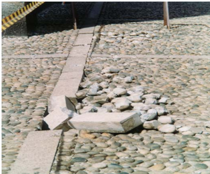
Pavimentazione stradale di pregio danneggiata
